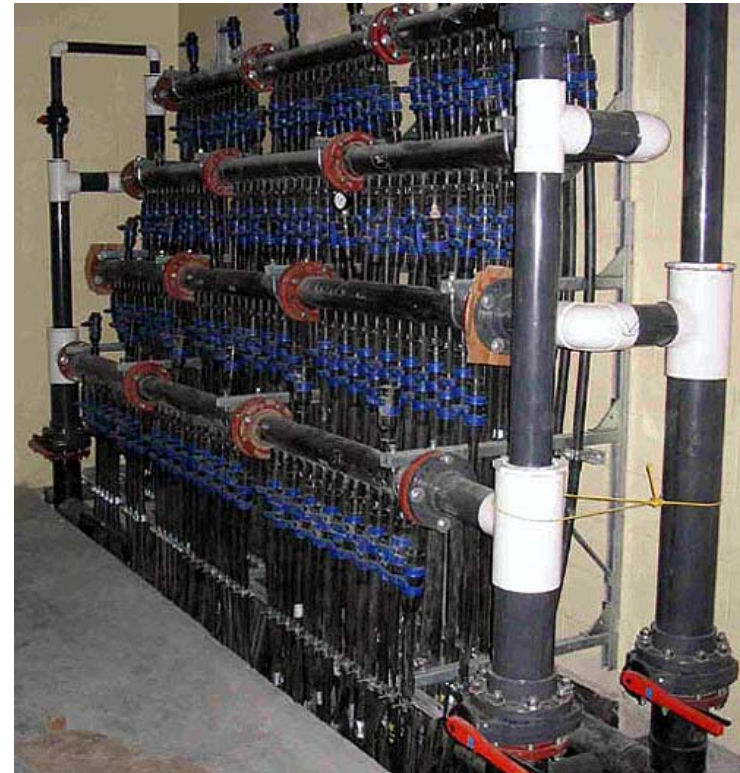
Sistema geotermal de Port Hawkesbury (Canada)
